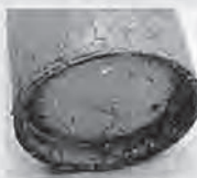
層状はく離腐食
