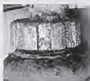
腐食している
